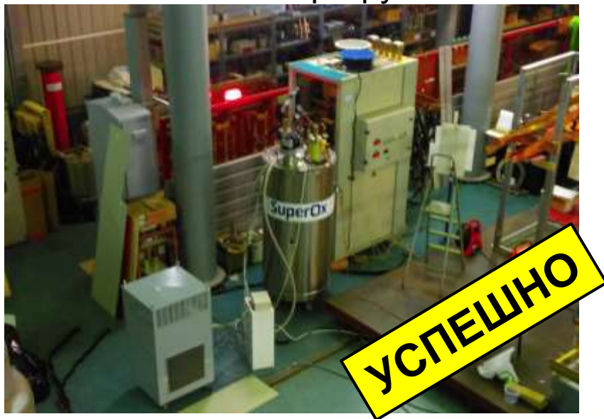
ВТСП ТОУ на испытаниях током перегрузки
