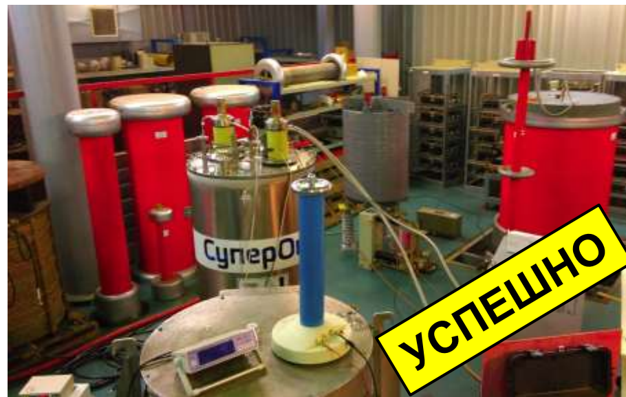
ВТСП ТОУ на высоковольтных испытаниях
